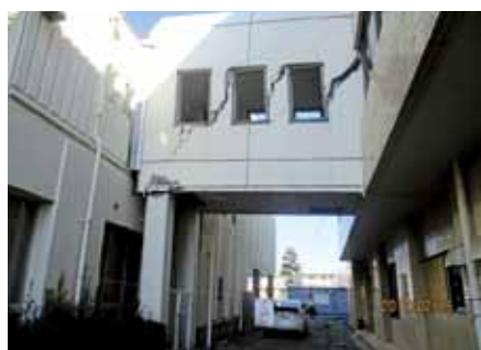
▲大きな亀裂が入り傾いた渡り廊下
