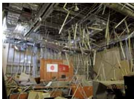
▲天井や壁が崩落した議場
